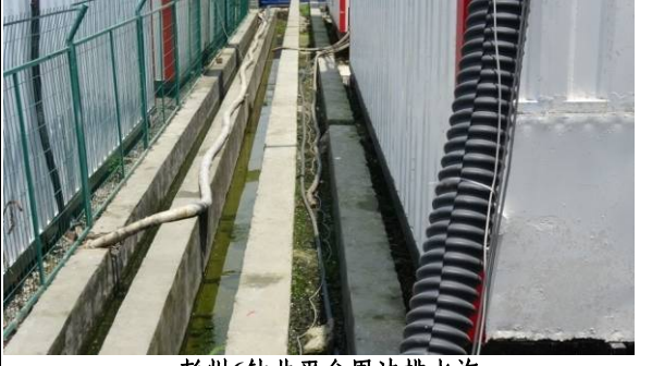
彭州6钻井平台周边排水沟
