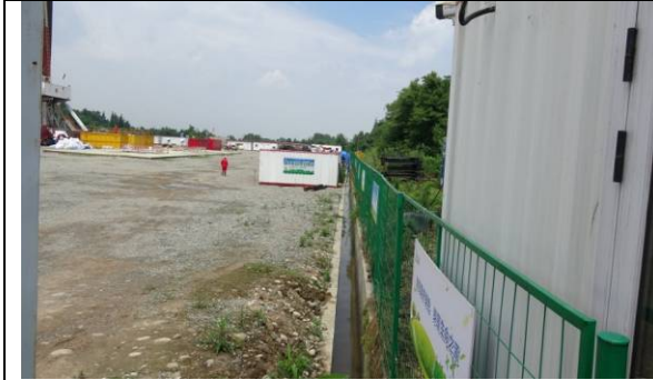
彭州8钻井平台周边排水沟
