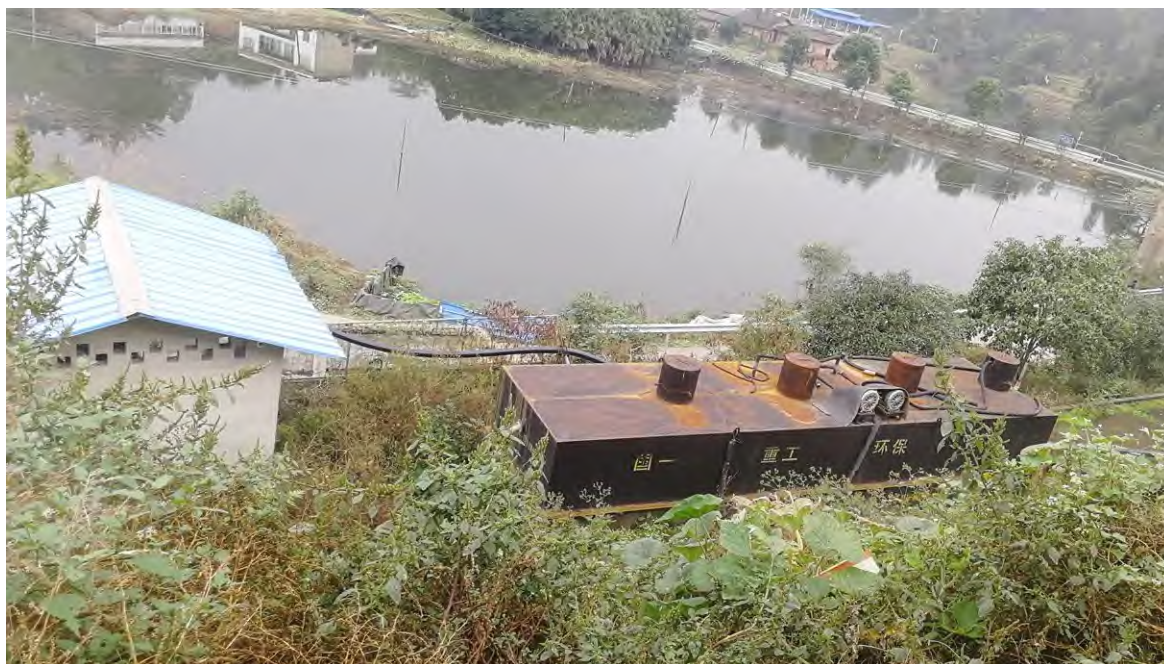
图 3.2-10 副斜井工业场地污水处理设施
