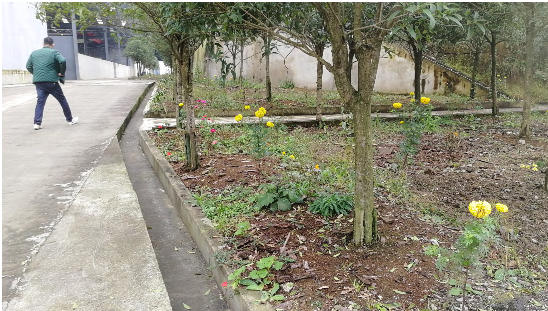
图 3.2-8 副斜井工业场地排水沟现状
