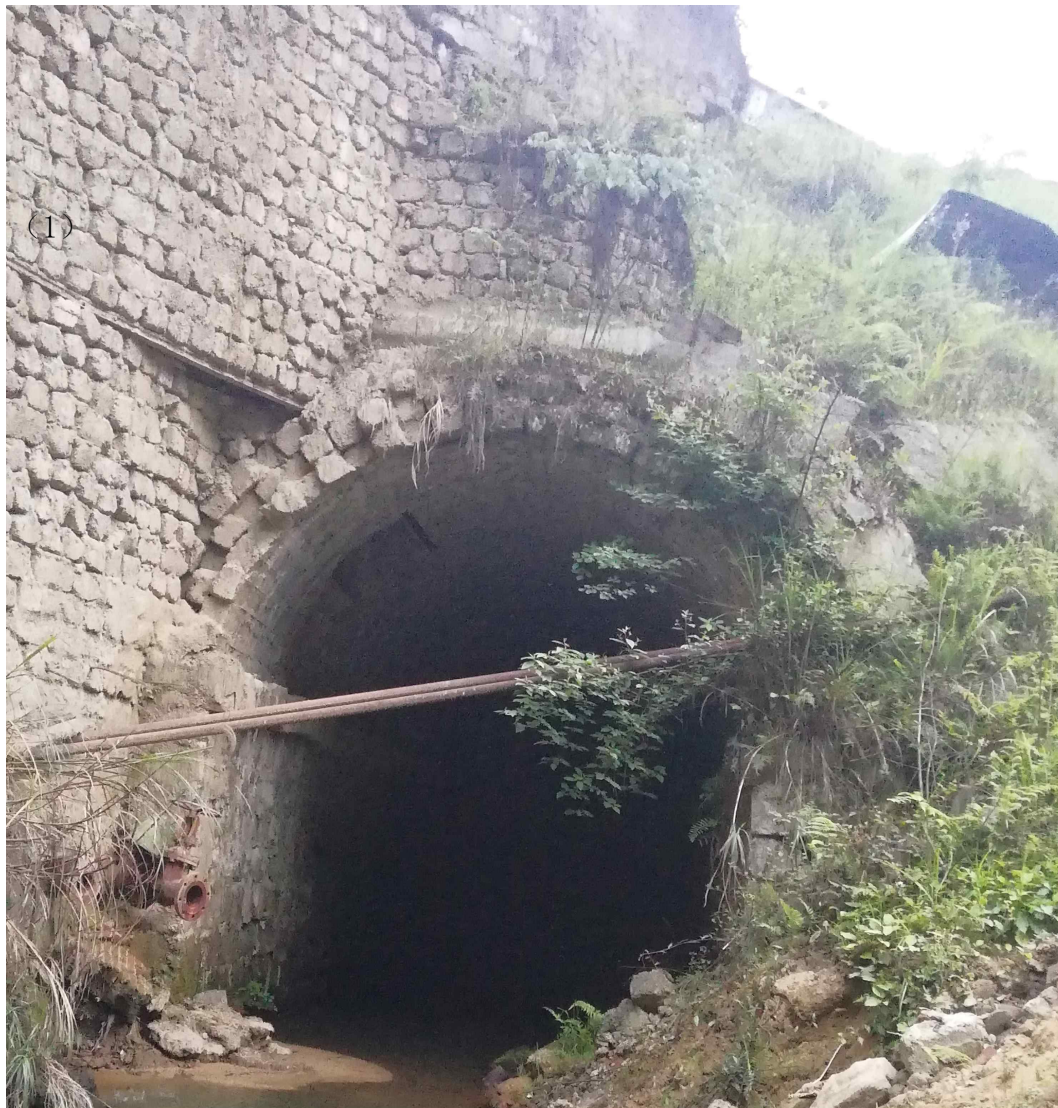
图 3.2-2 主斜井工业场地地下排洪道
