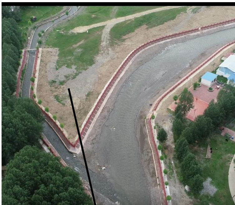
堤后回填区域存在裸露的情况
