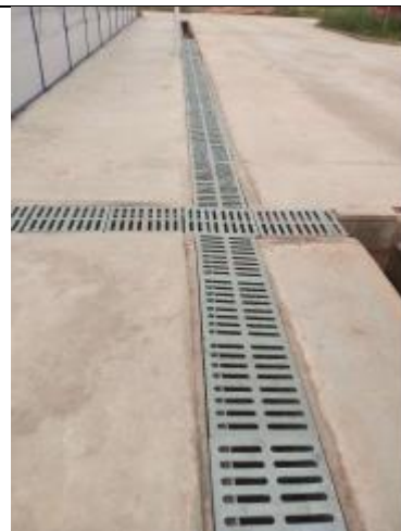
场内盖板排水沟
